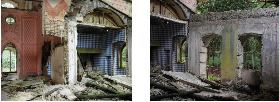
Figura 3.3 - Destruição parcial do Chalet , após o incêndio de 1999 (créditos PSML)
