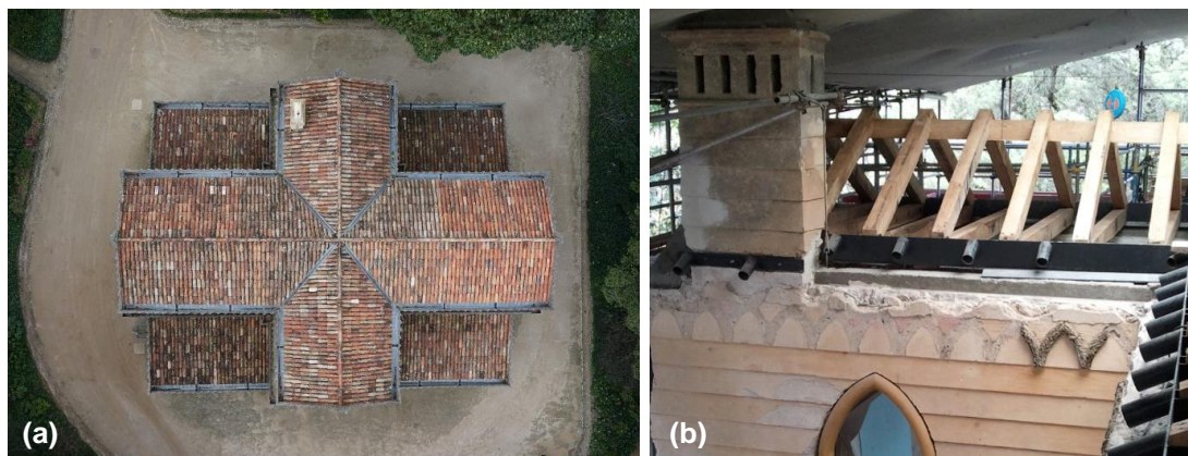
Figura 3.18 – (a) Fotografia aérea da cobertura do Chalet da Condessa d'Edla, captada com o drone propriedade do IST e (b) fotografia das asnas pequenas sem pendural (créditos PSML)
